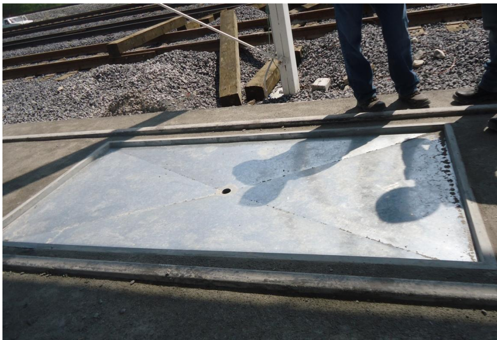
Fig. # 25. Charolas para canalización de derrames hacia fosa de contención.
