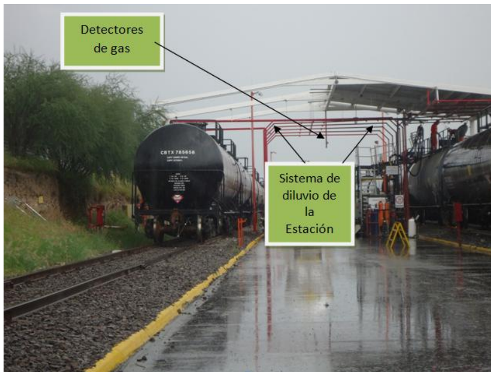
Fig. # 27. Ejemplo de Estación equipada para trasvase de combustibles líquidos.
