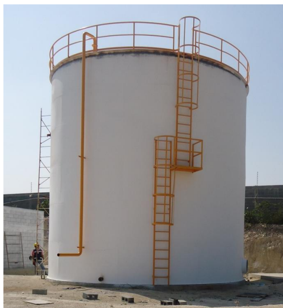
Fig. # 10. Tanque de almacenamiento de agua contra incendio
