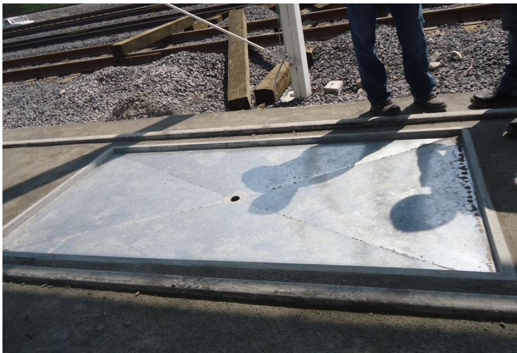
Fig. # 7. Charola fija para derrames en estación de trasvase de diésel.
