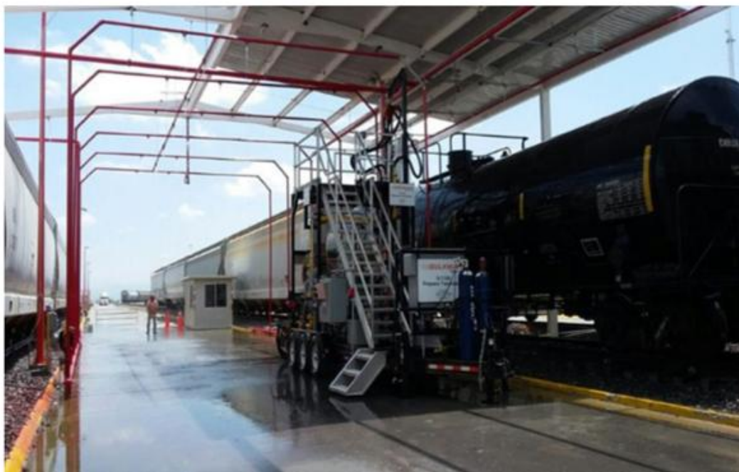
Fig. 15. Transloader para combustible gas L.P.
