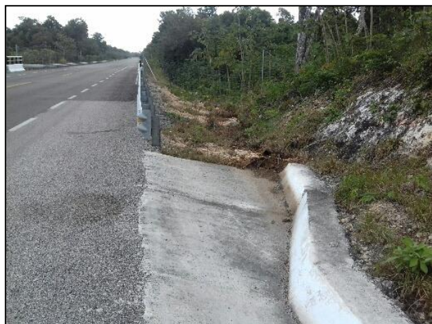
3 – El hidrocarburo derramado se desplazó por una cuneta de concreto hasta desembocar en suelo natural.
