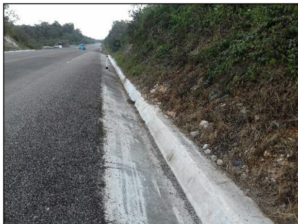
1 - Punto de impacto, a la altura del Km. 045 + 650 de la Carretera Federal 305-D, tramo El Cedral – Playa del Carmen.
