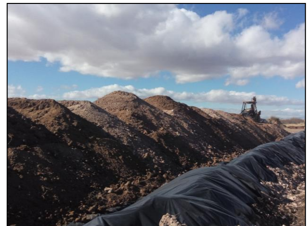
18.- Celda provisional con material dañado con Diésel.
