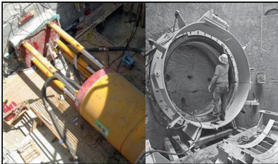
Figura II.35 Microtunneladora (MTBM) y gatos hidráulicos.
