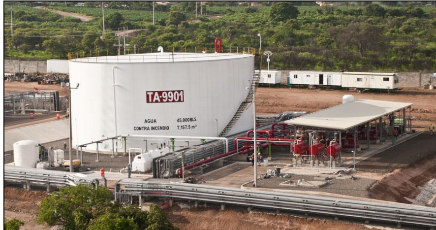
Foto II.3 Ejemplo de un sistema contra incendios.
