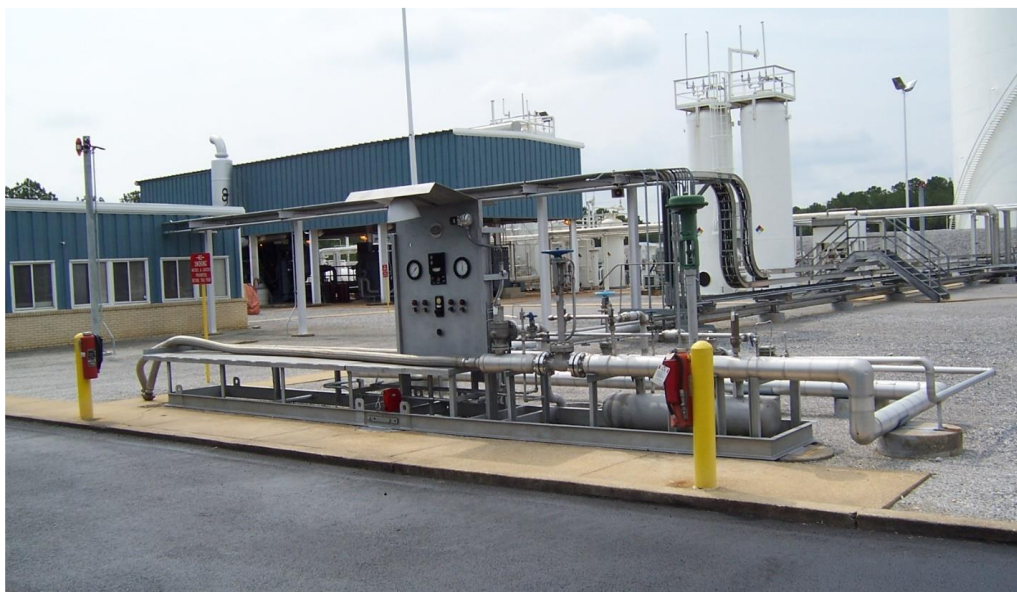
Figura II.7.- Estación de llenado de GNL similar a la planeada para el Proyecto
