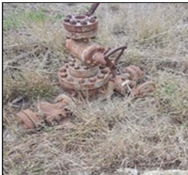
Figura 11. Mantenimiento a Conexiones Superficiales
