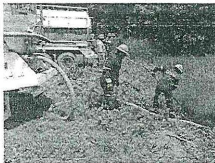
Fig. 9 Trabajos observados para recuperar el material líquido oscuro con olor característico a hidrocarburos.
