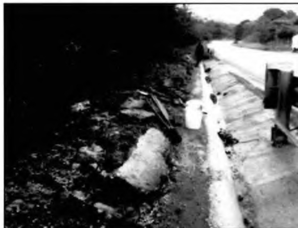
En el sitio se observa pedacería de carpeta asfáltica, concreto y escombros
