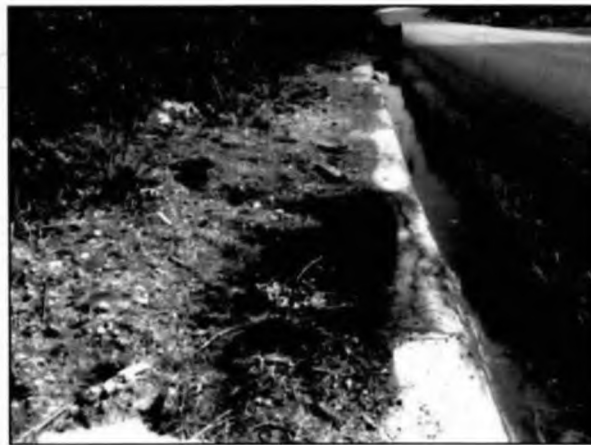
En el sitio impactado se observa una placa de concreto
