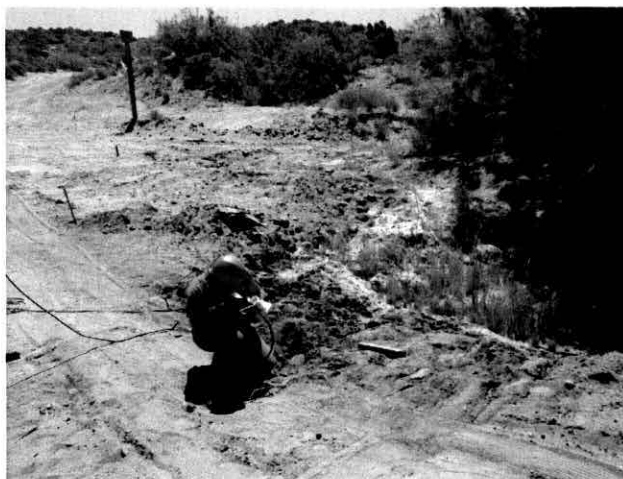
Figura 2. Sitio Afectado en km 95+988 del DDV poliducto de 10"-8"Ø Rosarito-Mexicali.
