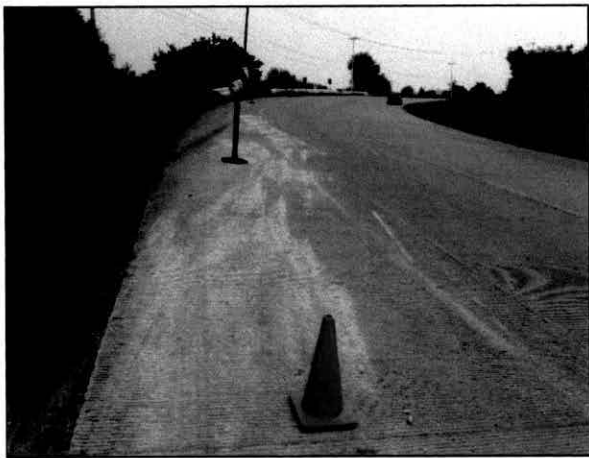
Se colocó la correcta señalización en el sitio, para evitar cualquier incidente
