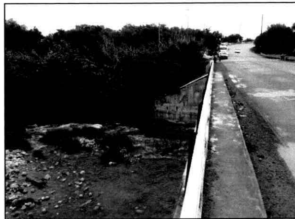
A aproximadamente 75 m del sitio donde se suscitó el derrame se encuentra ubicado el Río San Juan sin ser afectado por el hidrocarburo derramado
