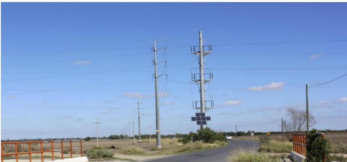
Figura 84 Línea de transmisión eléctrica en la carretera Río Bravo – Progreso.
