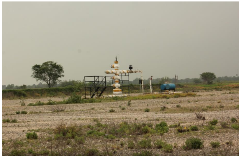
Fotografía 16 Coordenadas UTM X: 600449.00 Y: 2876864.00 Necesaria limpieza al cuadro de maniobras del pozo Ricos 17.
