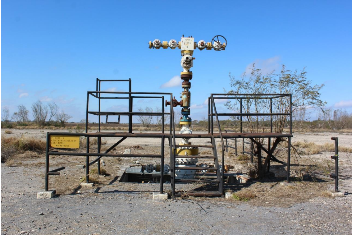
Fotografía 9 Coordenadas UTM X: 602901.00 Y: 2876598.00 Pozo inactivo Ricos 9. Cercado en malas condiciones.
