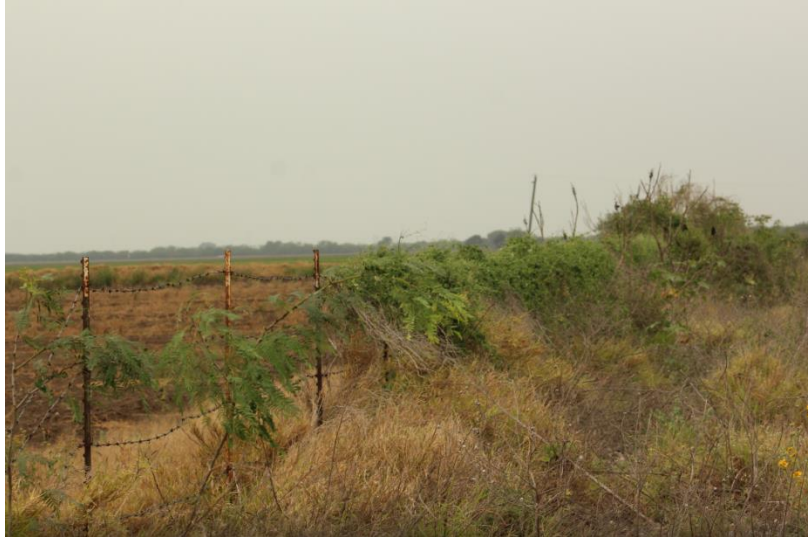
Fotografía 15 Coordenadas UTM X: 600529.00 Y: 2876856.00 Cercos perimetral en mal estado.
