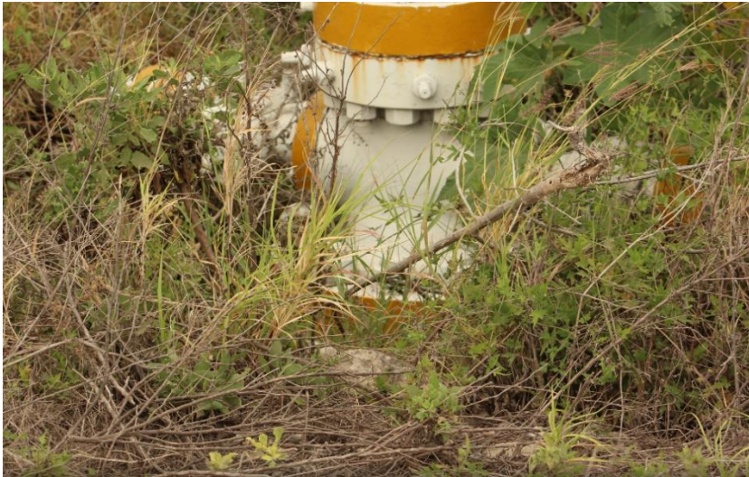
Fotografía 12 Coordenadas UTM X: 600431.00 Y: 2876846.00 El contrapozo del pozo Francisco Cano no tiene rejillas de protección, además está cubierto de vegetación.
