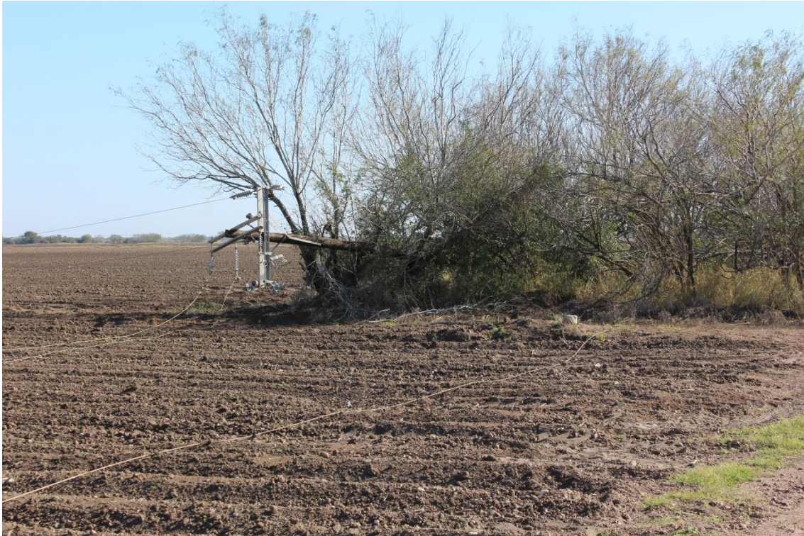
Foto 37 Poste de tendido eléctrico caído a al lado norte del trazo del camino de acceso.
