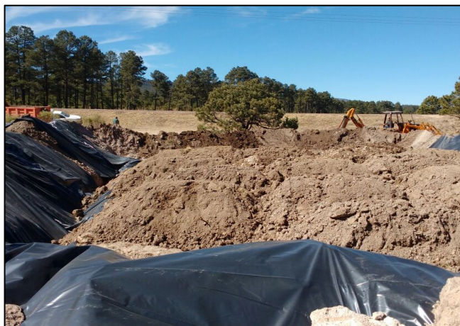
11.-Vista del material edáfico afectado en la celda provisional.
