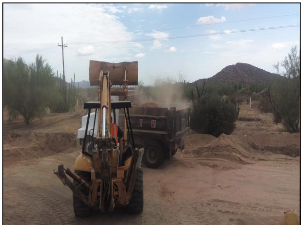
9.- Depósito de material edáfico afectado con Diésel en camión de volteo para su posterior acarreo y deposito a la celda provisional.
