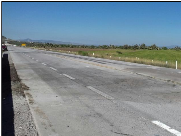
1.- Sitio del accidente en el Km. 76 + 300 de la Carretera No. 80-D Villa de Arriaga – Lagos de Moreno, municipio de Villa de Arriaga, estado de San Luis Potosí.
