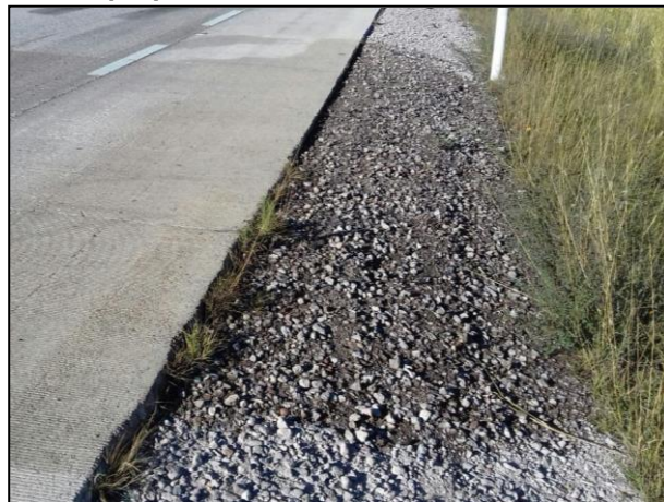
2.- Talud afectado por el derrame de Diésel, en él se encuentra abundante gravilla.
