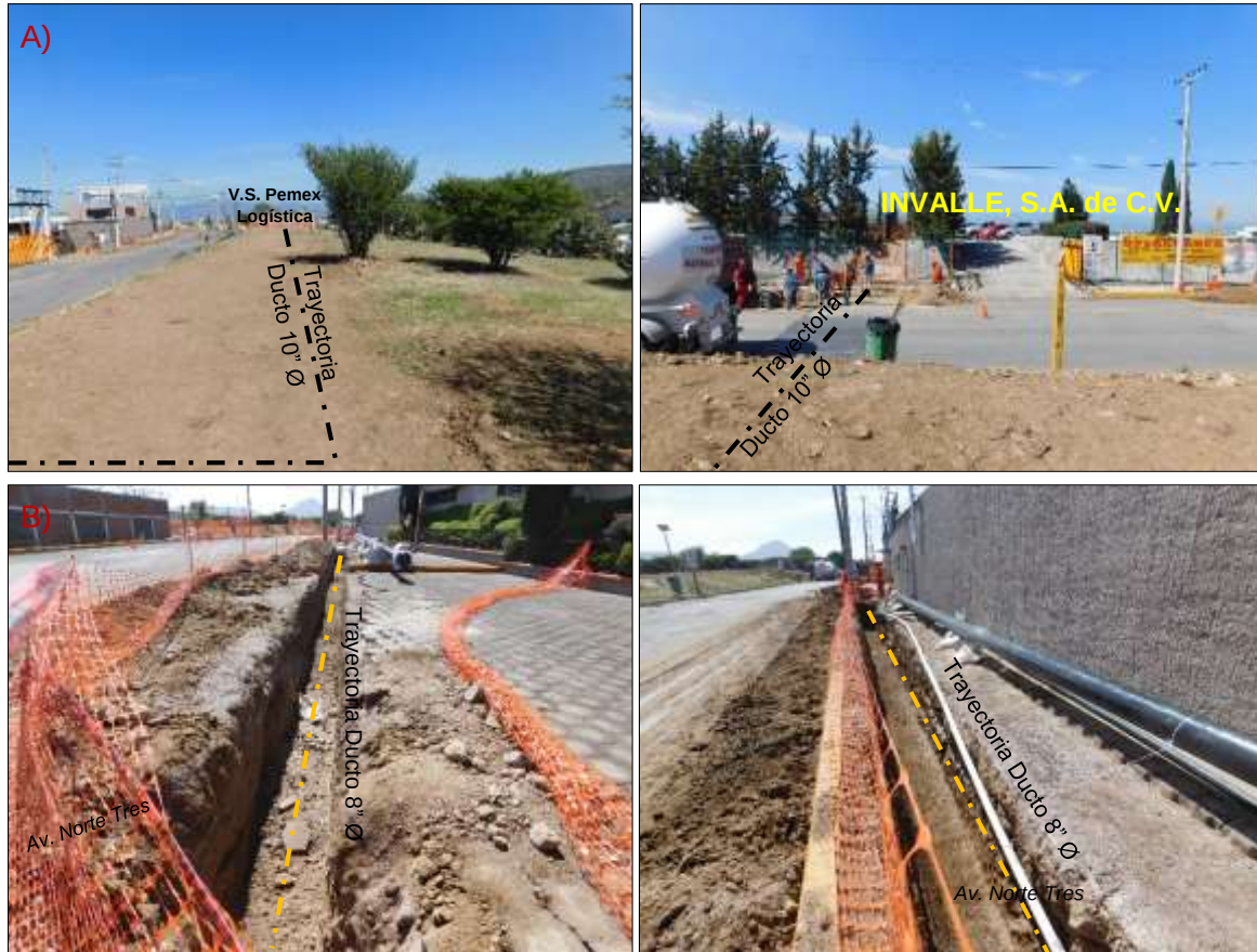
Figura II.5. A) Área donde se aloja el ducto de 10"Ø, se localiza en el terreno del lecho de la trayectoria del gasoducto de 20" de PEMEX TRI Cactus-Guadalajara hacia el terreno de las instalaciones de INVALLE S.A. DE C.V. B) Trayectoria del ducto de 8" Ø sobre terreno cubierto por asfalto.
