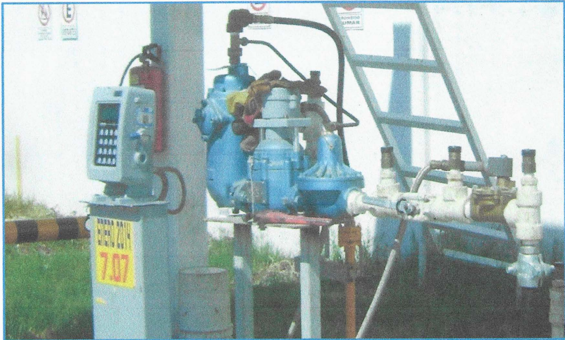
Figura III.1.c)-1. Dispensario doble para el Gas L.P.
