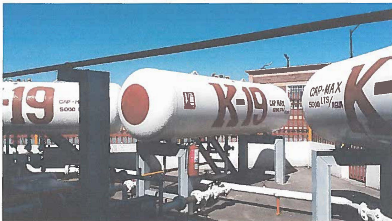
Foto 3 Vista del área de almacenamiento, se han instalado tres tanques. se observa pisos de concreto con sus drenajes, las bases de sustentación y sistemas de conducción sustentados al piso.
