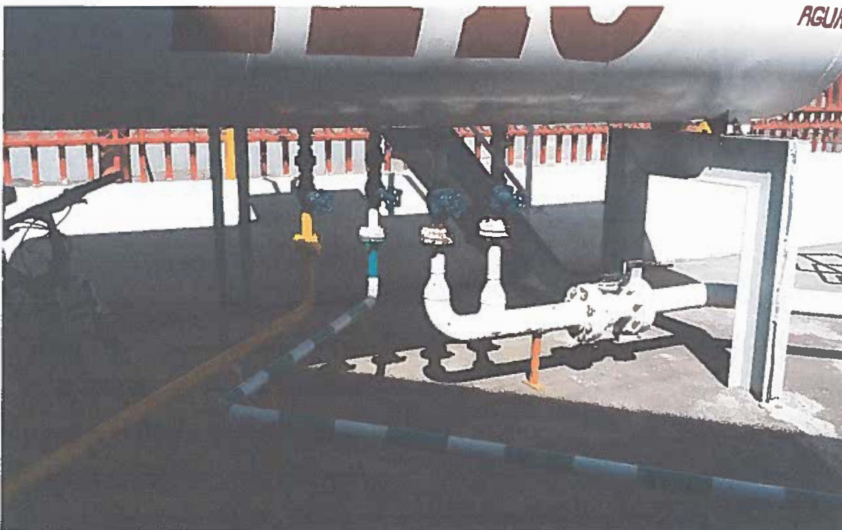
Foto 7 Vista del arreglo de válvulas y tuberías que tienen los tanques de
