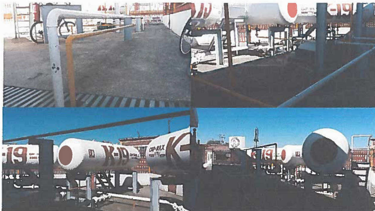
Foto 9 Sistema de tuberías instaladas en la estación de carburación.
