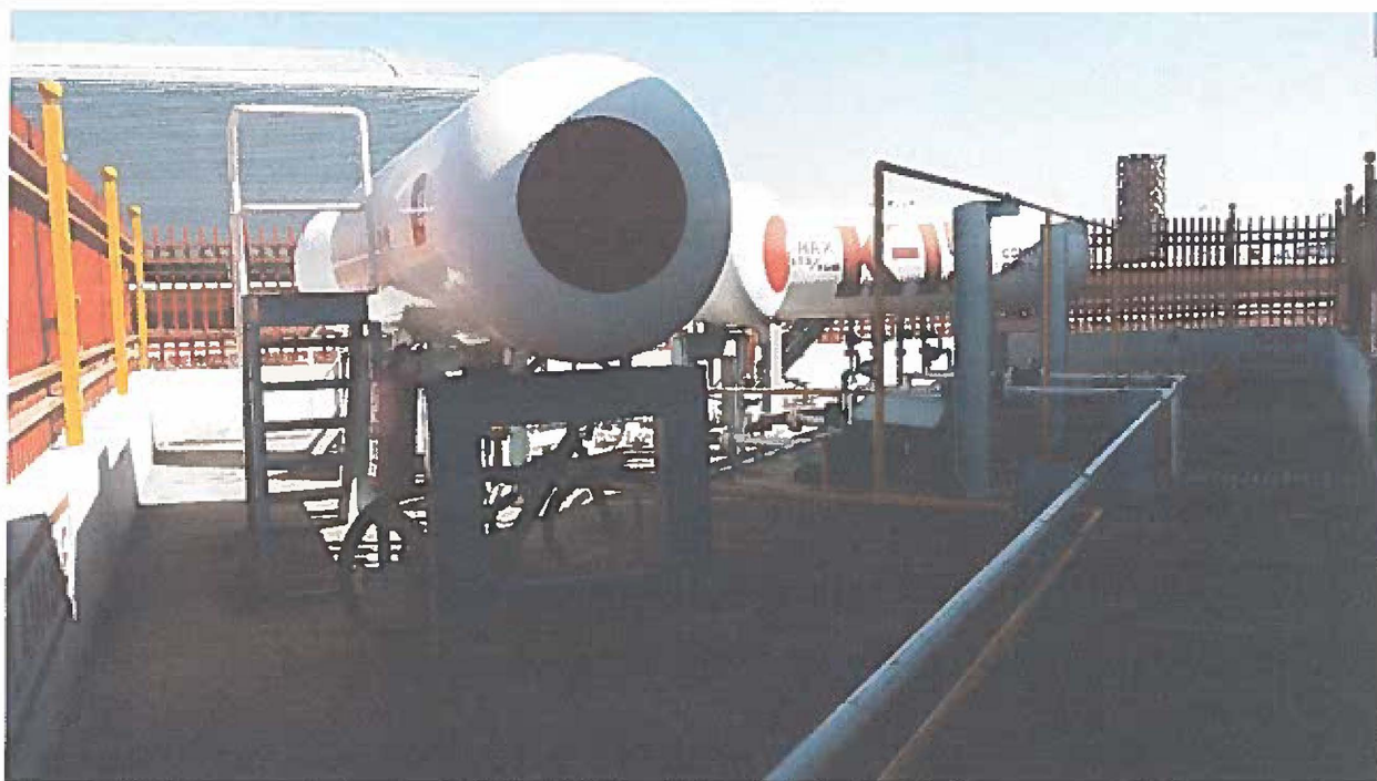
Foto 4 Tanques de almacenamiento aislados del resto de las instalaciones por medio de un murete.
