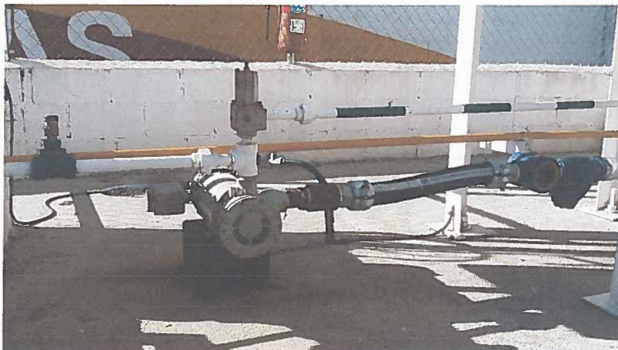
Foto 4 Bomba de suministro a los vehículos automotores.
