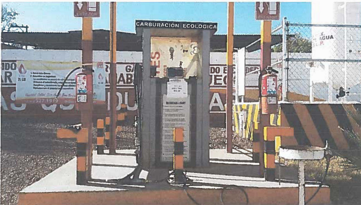
Foto 6 Mangueras en tomas de suministro.
