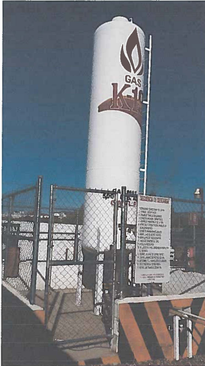
Foto 3 Base de sustentación del tanque.
