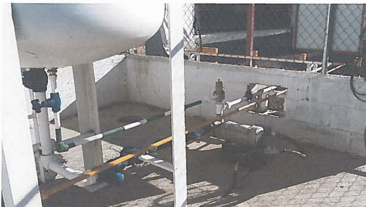
Foto 5 Sistema de tuberías-
