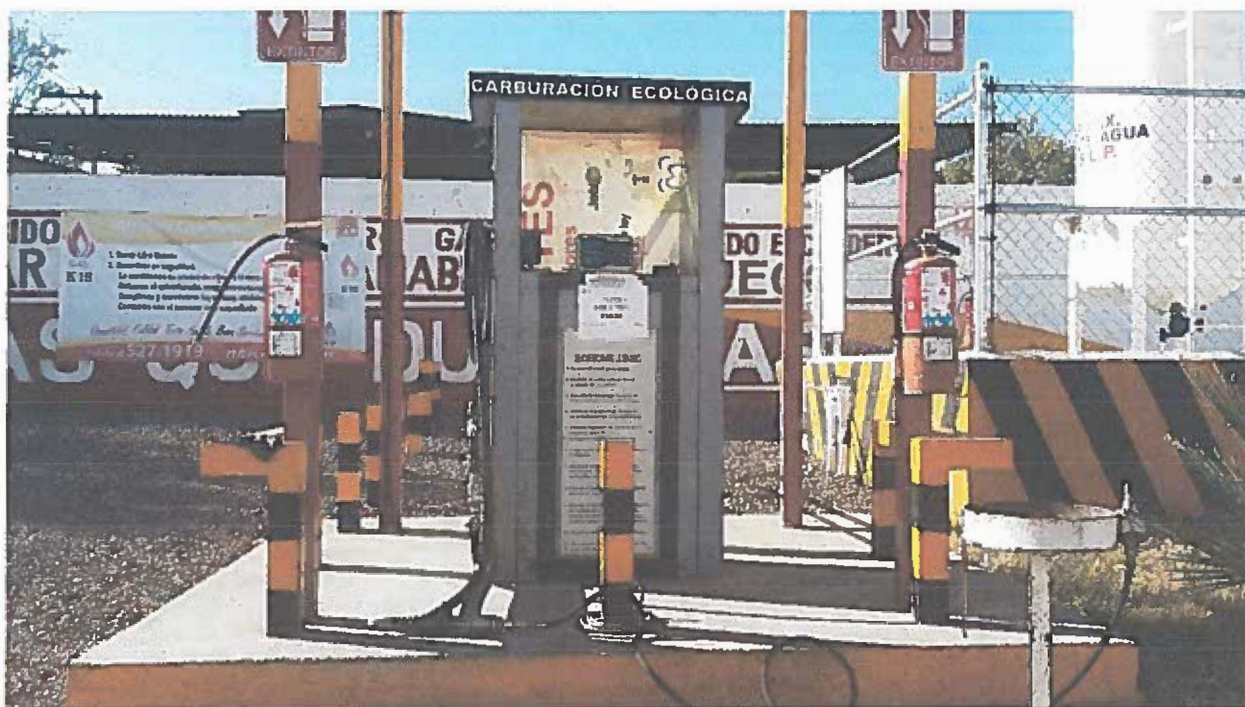
Foto 2 Protección de la Isla de Suministro.
