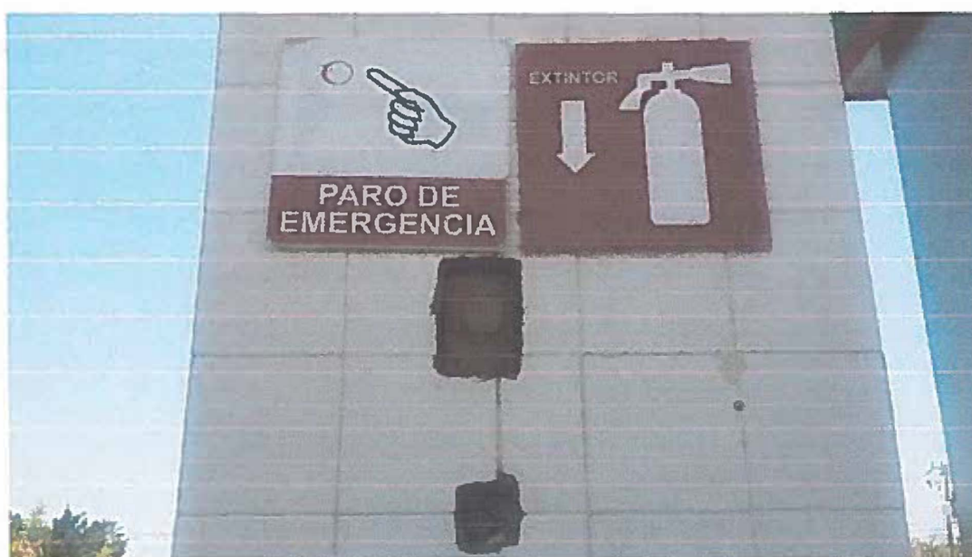
Fotografía 5. Paro de emergencia en dispensarios.
