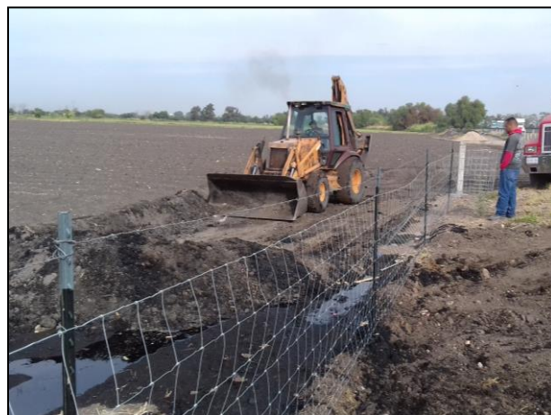
8.- Se retiró el material edáfico del área afectada por el derrame de Combustóleo, situada en propiedad privada misma que es utilizada como zona de cultivo.
