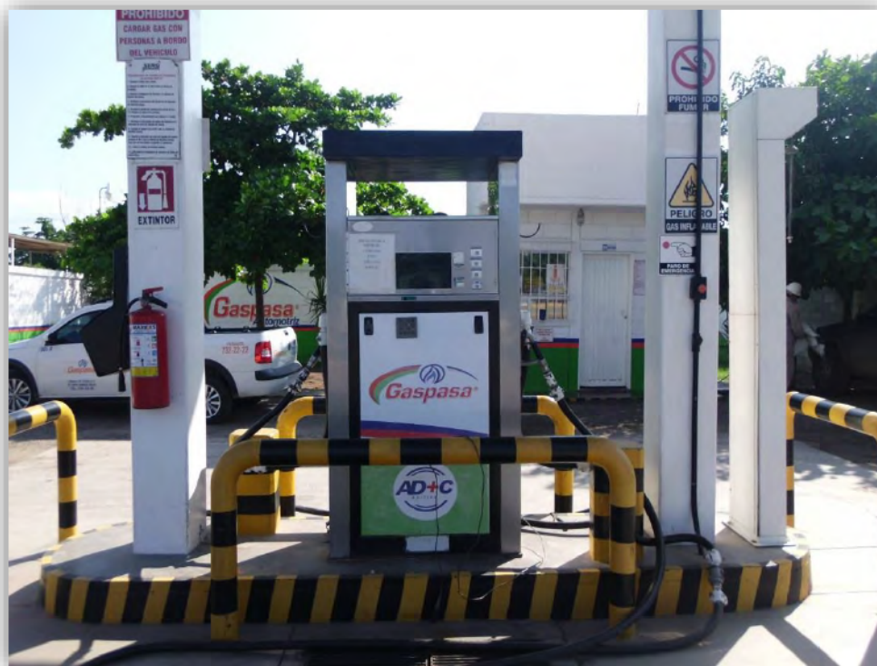
FIGURA 10: Suministrador 1, ubicado en la estación de servicios “Guamúchil Sur”
