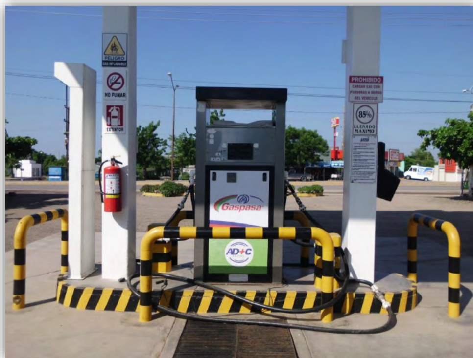
FIGURA 11: Suministrador 2, ubicado en la estación de servicios “Guamúchil Sur”
