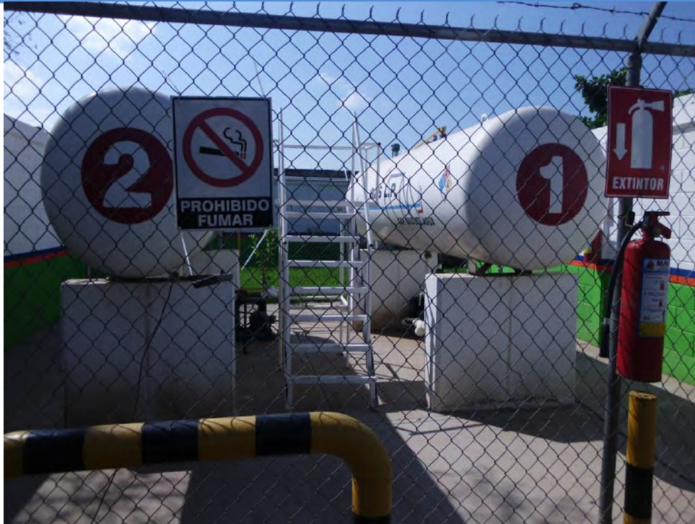
FIGURA 6. Tanques de almacenamiento de 5,000 L cada uno.
