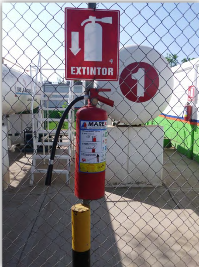
FIGURA 7: Extintor Ubicado a un costado de uno de los suministradores de gas L.P.
