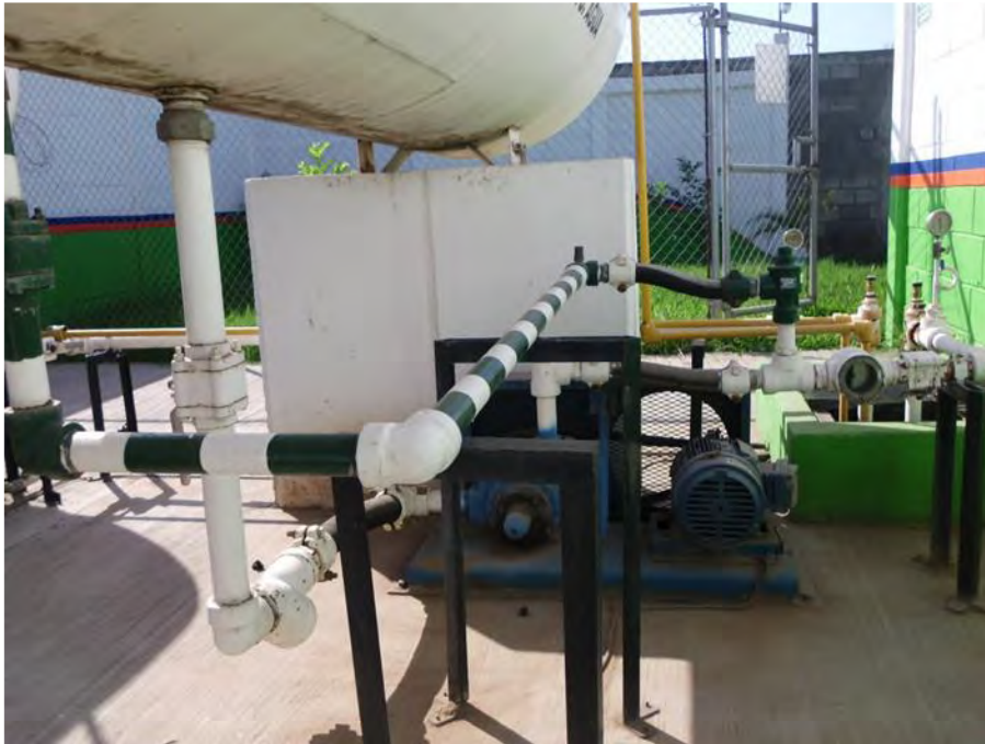
FIGURA 9: ubicación de las bombas y tubería, dentro de la Estación de servicios “Guamúchil Sur”
