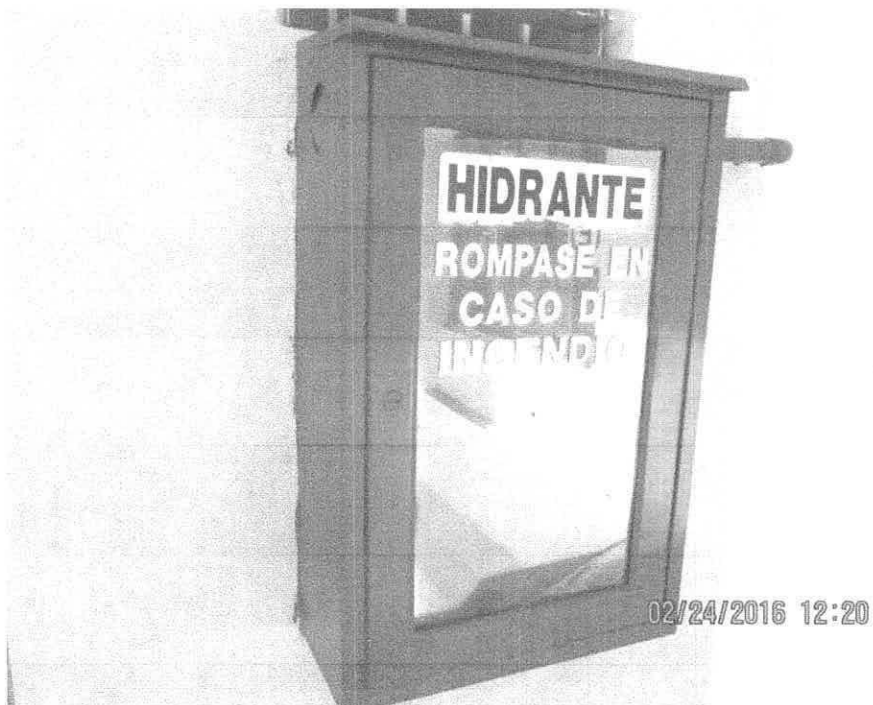
Fotografía No. 10.- Hidrante.
