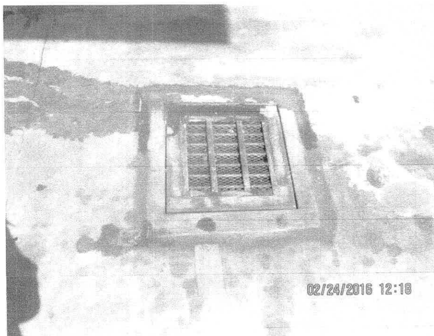
Fotografía No. 5.- colector de aguas aceitosas y con combustibles.
