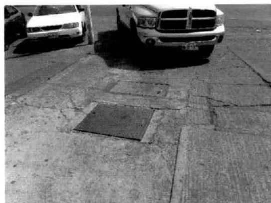
Registros de trampa de combustible.
