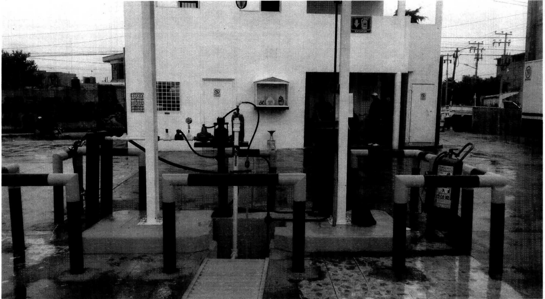
Figura 30. Vista general de la Estación de Gas L.P. Chimalpa; zona de oficina W.C , entrada y salida
