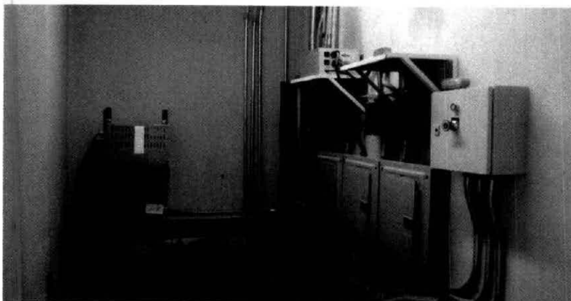
Foto 5. Cuarto de Controles Automatizados.
