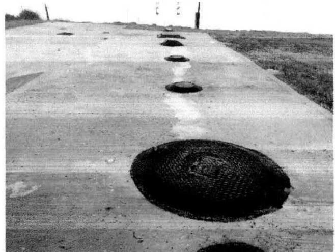
Fosa de concreto que alberga el tanque de Diesel de 100,000 lts.
