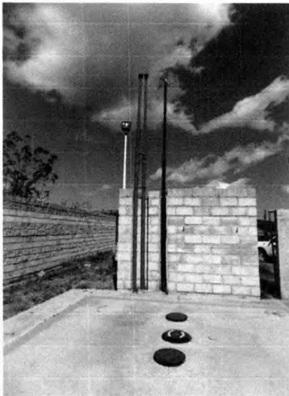
Figura 19. Imagen de los tubos de venteo instalados en la E.S.
