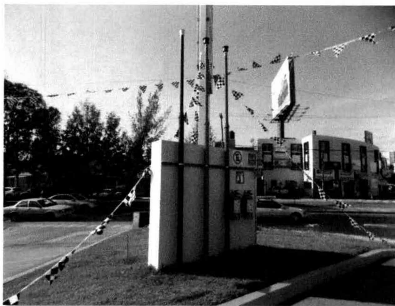
Figura 17. Imagen de los tubos de venteo instalados en la E.S.
