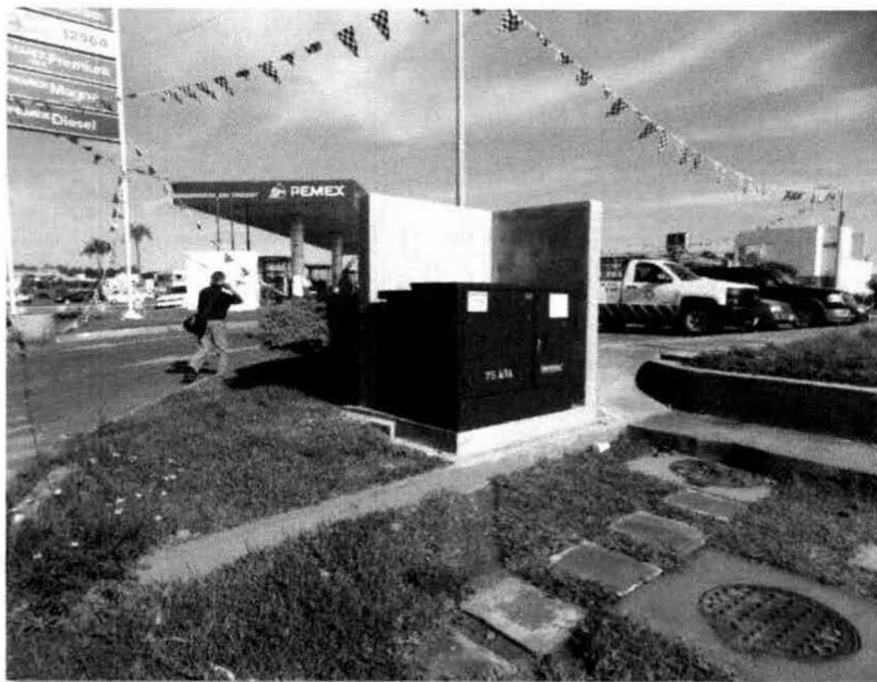
Figura 22. Uno de los transformadores con que se cuenta en la gasolinera.
