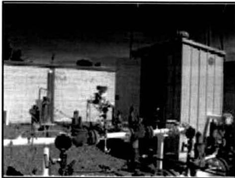
Figura III. 23. Patín de regulación, reguladores y caseta de medición.
