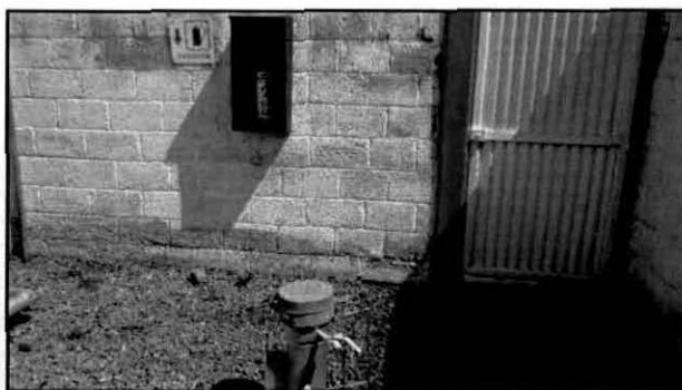
Figura III. 22. Depósito de mercaptano de 54 galones.
