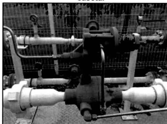
Figura III. 32. Patín de regulación, reguladores Fisher.
