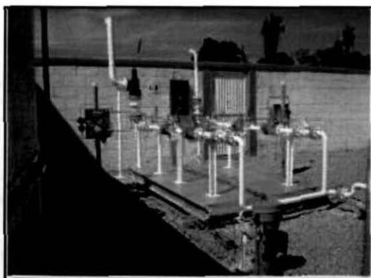
Figura III. 21. Patín de regulación, reguladores, válvula de seguridad de desfogue y depósito de mercaptano (odorizador).
