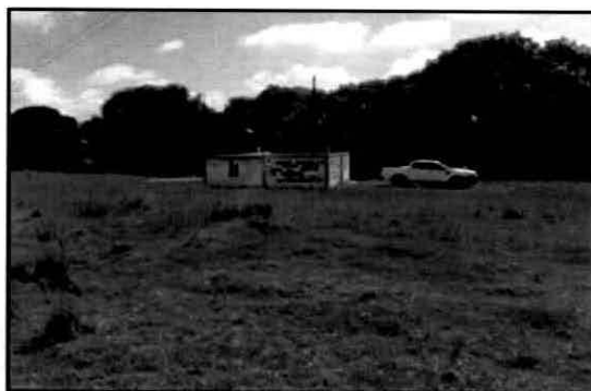
Figura III. 11. Estación de Medición y Regulación del punto de interconexión (vista frontal).
