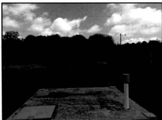
Figura III. 9. Registro de concreto con tapa de acceso y respiradero.
