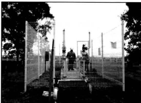
Figura III. 29. Caseta de Regulación de CELFIMEX.
