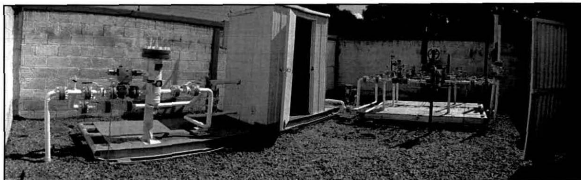
Figura III. 14. Interior de la Estación de Medición y Regulación.
