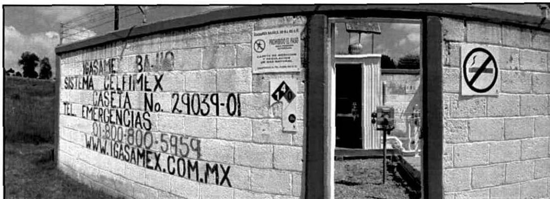
Figura III. 13. Estación de Medición y Regulación.
