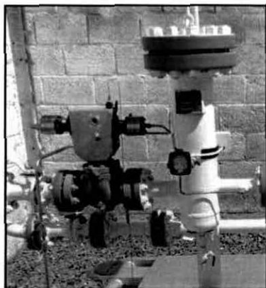
Figura III. 15. Válvula de seguridad "Slam Shut" de corte automática, y filtro Coalescente.
