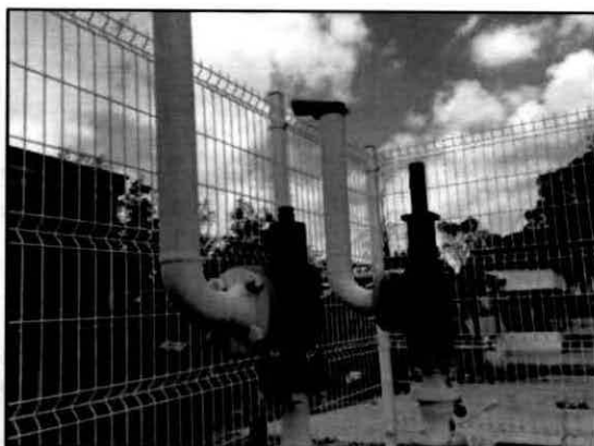
Figura III. 33. Válvulas de seguridad de las dos líneas de regulación (a cogeneración y a quemadores).
