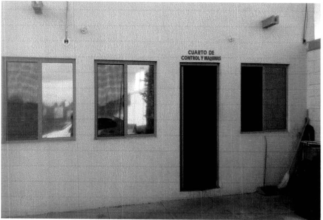
CUARTO DE CONTROL Y MAQUINAS
