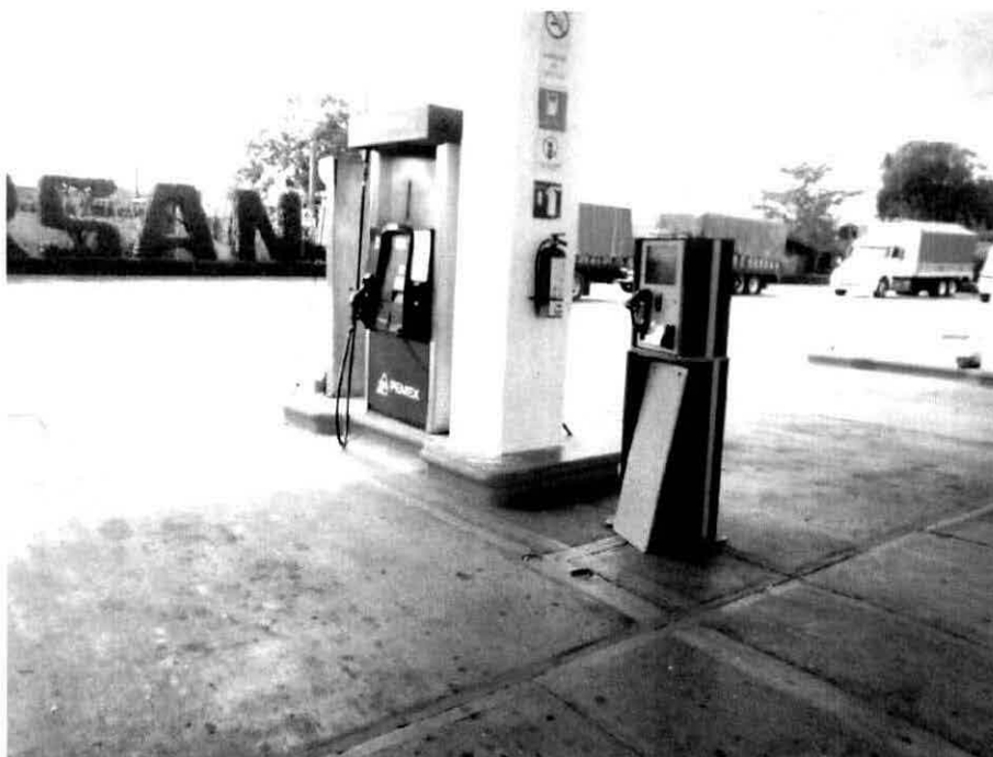
Figura 2. Dispensarios de la estación de servicio.
