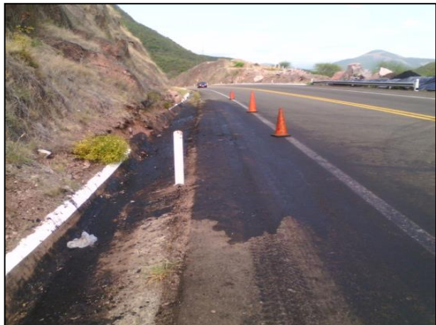
1.- Se instaló la correcta señalización en el lugar del siniestro.
