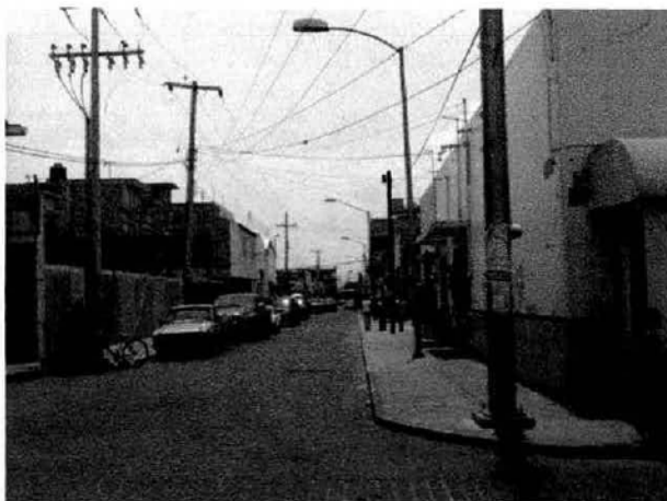
Fotografía Alumbrado público zona centro
