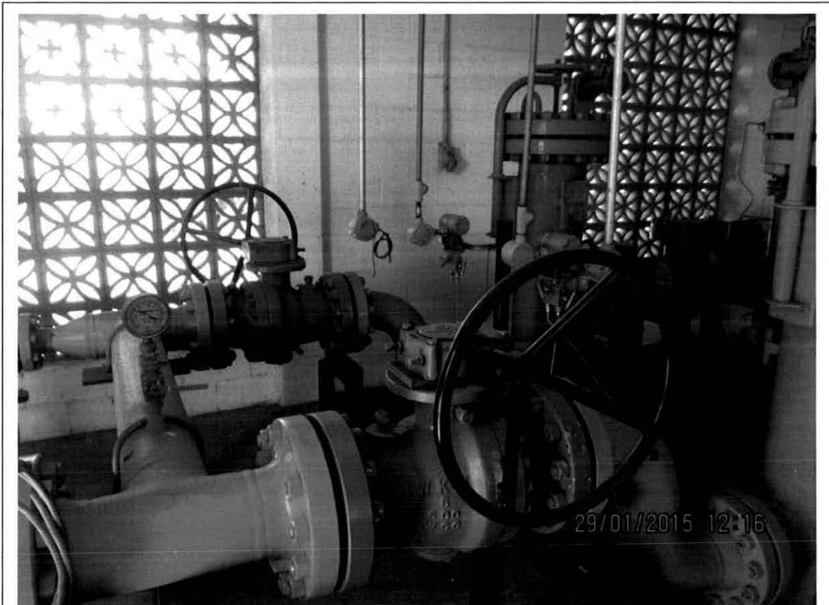
Fotografía No. 2.- Tren de regulación y filtración de la City Gate Irapuato. El tren de filtración está compuesto por filtros coalescedores, y el tren de regulación, está conformado por reguladores pilotados. Adicionalmente se observa que dichos sistema se encuentran conectados al sistema SCADA.
