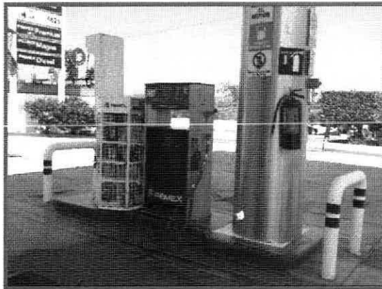
Foto 3.- Dispensario de gasolina con la instalación de servicios
