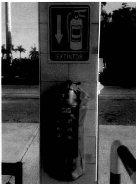
FIGURA 6: Extintor Ubicado a un costado de uno de los suministradores de gas L.P
