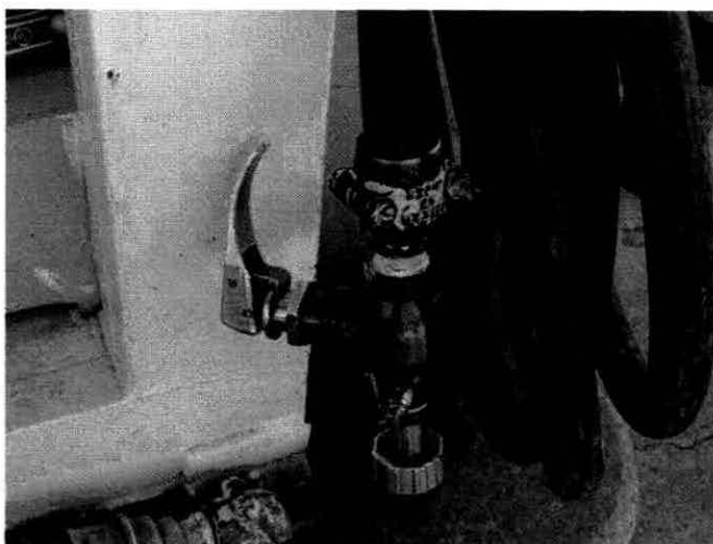
Imagen 20. Mangueras de Control.
