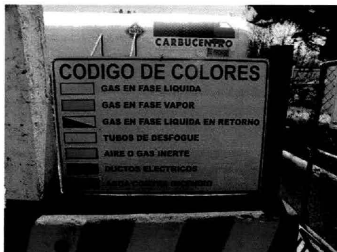
Imagen 10. Identificación de tuberías.
