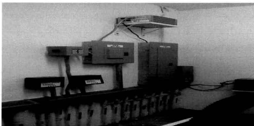
Foto 5. Cuarto de Controles Automatizados.
