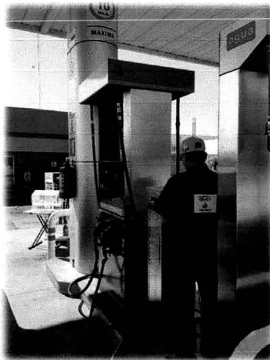
E esta imagen se observa las bombas de gasolina con que cuenta la estación.
