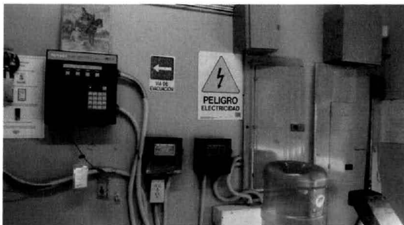
Foto 5. Cuarto de Controles Automatizados.
