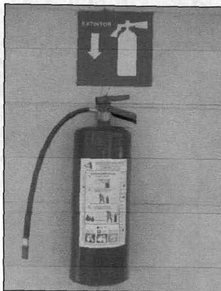
Fotografía 6. Equipo contra incendio en área administrativa.
