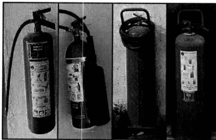
Imagen 10. Evidencia de ubicación de extintores.
