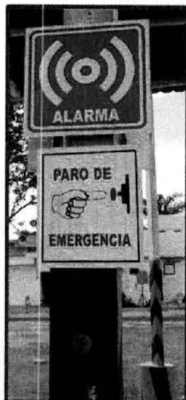
Imagen 11. Alarma Contra Incendio.
