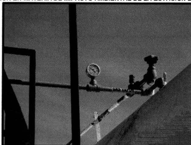
Imagen 6. Identificación de tuberías.
