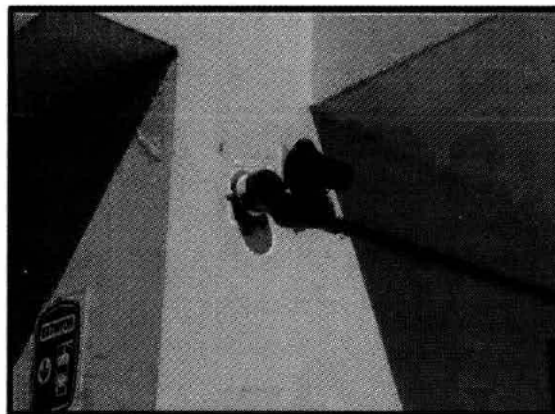
Imagen 8. Alarma contra incendio.
