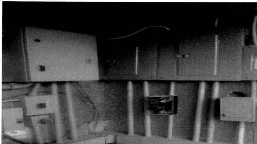
Foto 5. Cuarto de Controles Automatizados.
