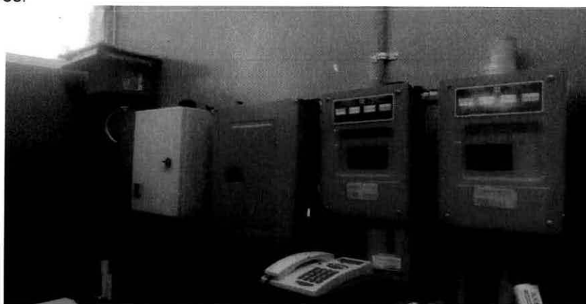
Foto 5. Cuarto de Controles Automatizados.
