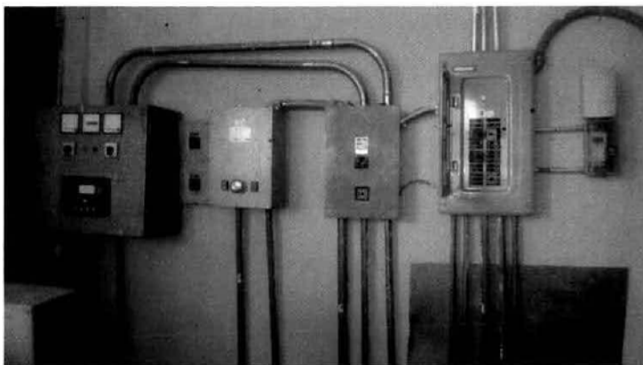
Foto 5. Cuarto de Controles Automatizados.
